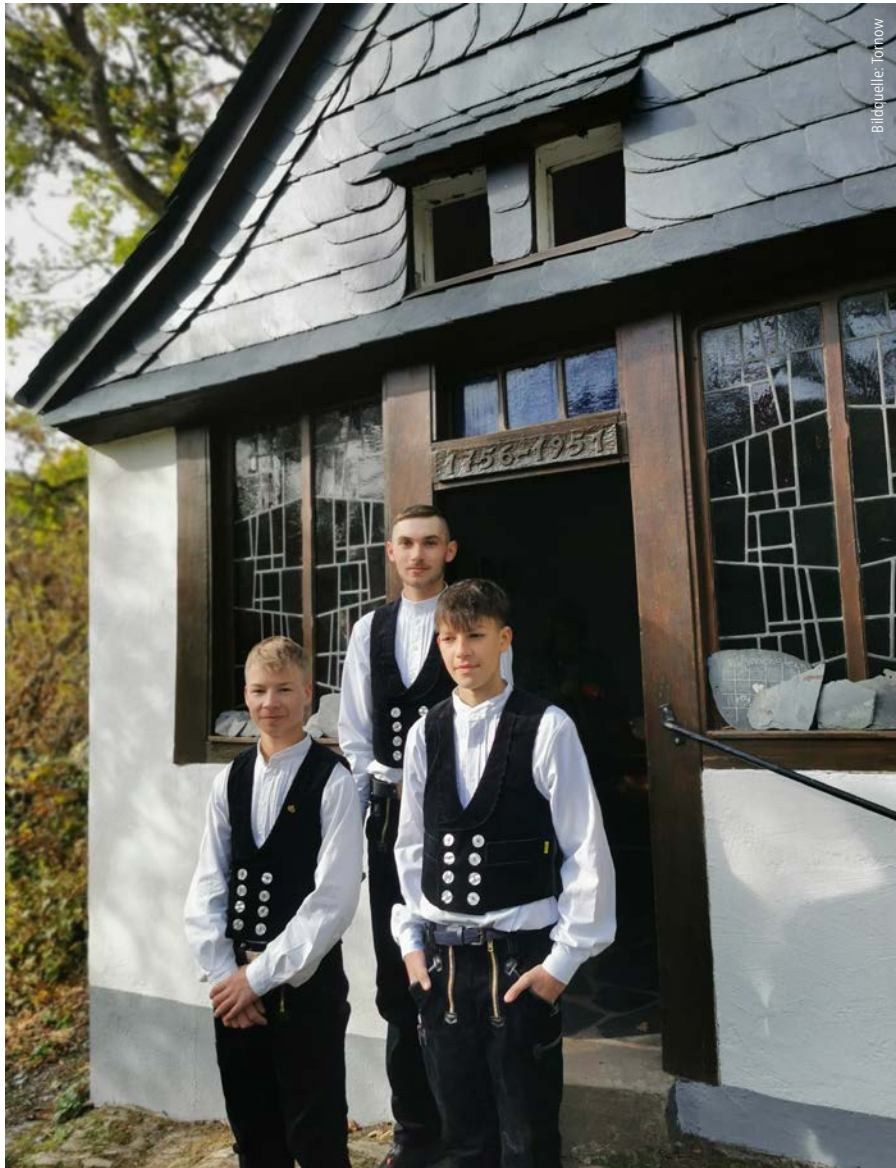
Fast noch Kinderarbeit: Unter der Leitung von Jung-Geselle Leon Diederich (hinten) deckten die Dachdecker Azubis Linus Esseln (links) und Pierre Lemesle das Dach der maroden Marienkapelle.
